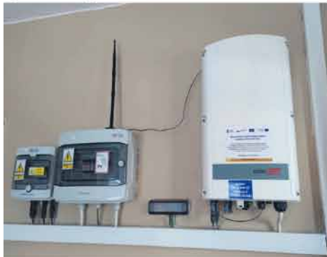
Każdy uczestnik programu musi też znaleźć na swojej posesji miejsce na urządzenia kontrolujące pracę instalacji.
