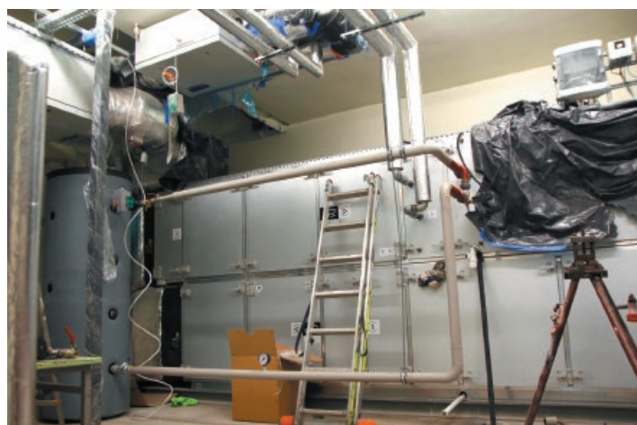
Sterownia nawiewu i ogrzewania
